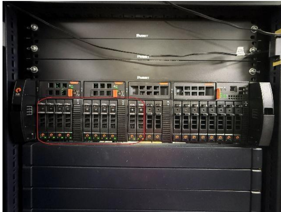
Imagen 10 Módulos instalados actuales.
